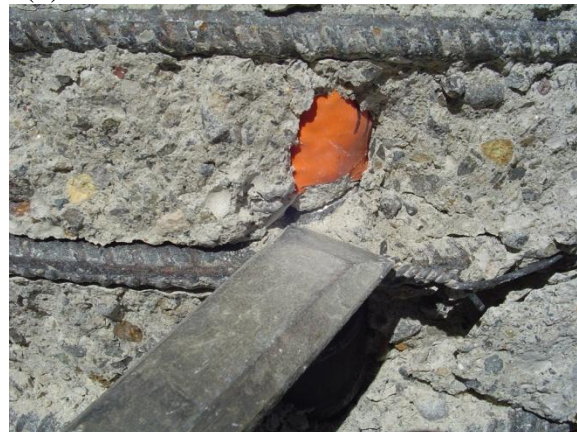
(d) Fractured longitudinal bar on East face
